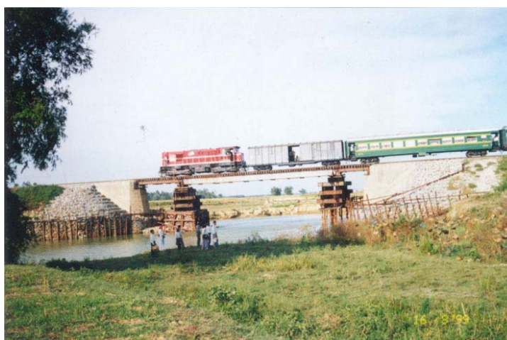
Hình 4. Lòng sông cổ tái hoạt động trong mùa lũ 1998, tạo vụng xoáy sâu 13m gây sập cầu đường sắt Bàu Tai
